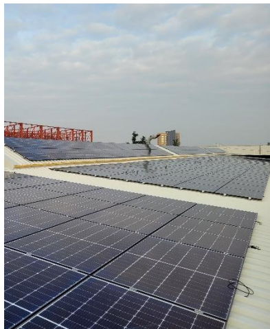
Impianto fotovoltaico da 905,58 kWp su magazzino di Imola
