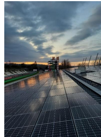
Repowering impianto da 108 kWp sull'Autodromo di Imola
