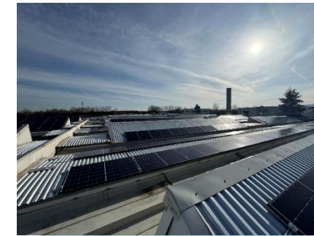
Impianto SEU da 437 kWp a Castel S. Pietro Terme
