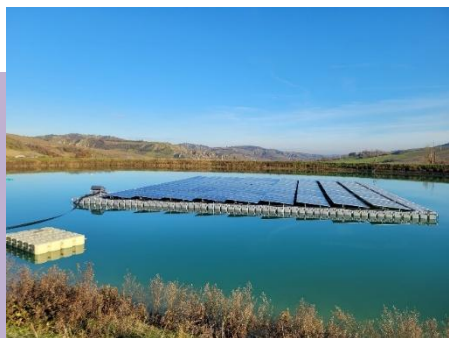
Impianto fotovoltaico galleggiante da 99 kWp a Imola
